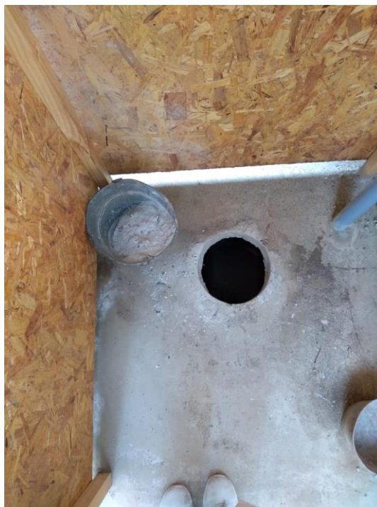
Figura 80: Estado del Bañito casi 7 meses después. Fuente (Huawei P9, 2019)
