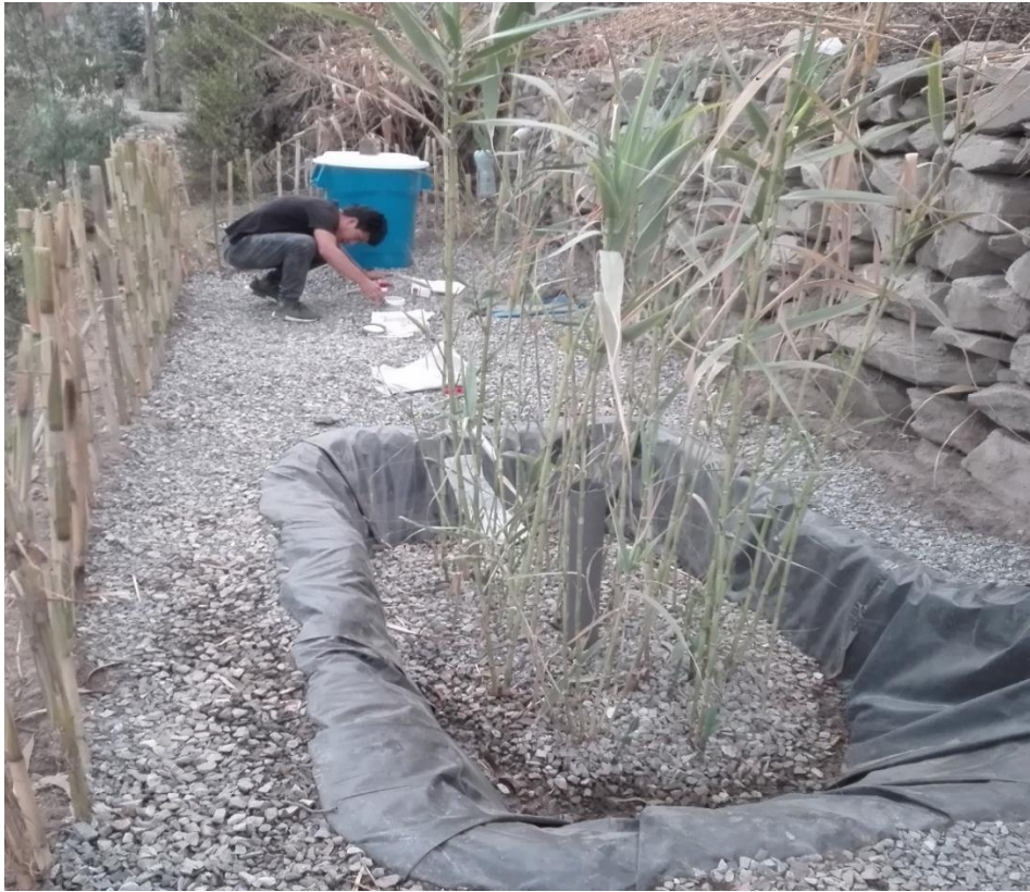
Figura 82. Puesta en marcha del sistema de tratamiento con aguas residuales
