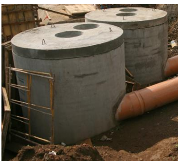
Figura 9: Pozo de Absorción
