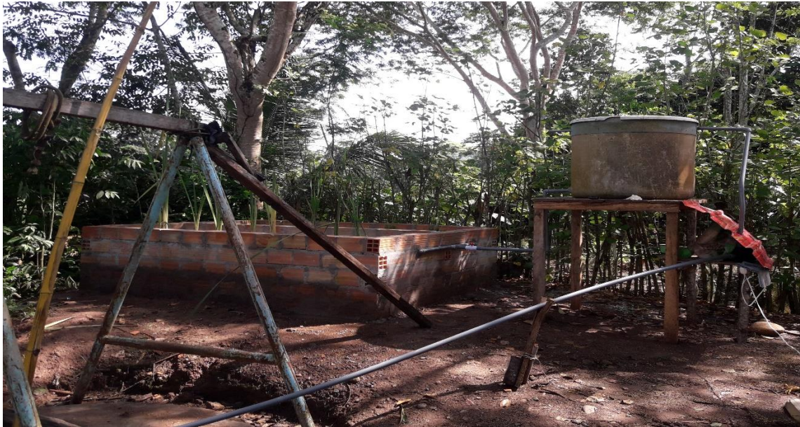
Anexo 20.13 Sistema de Humedal Artificial horizontal sub superficial
