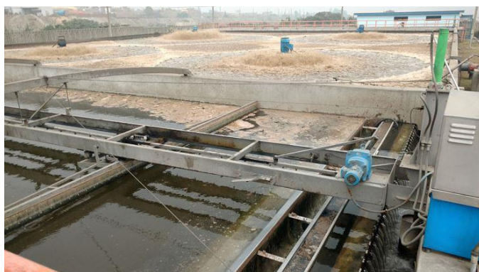
Figura 46. PTAR San Antonio de Carapongo, ubicada en la urbanización con el mismo nombre para el lado del río. Fuente: Aqualep, 2020.
