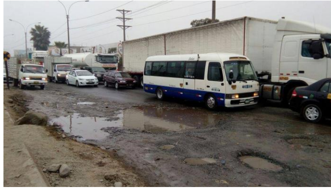
Figura 35. Baches en el Paradero Horacio Zevallos en la Carretera Central. Fuente: Te amo Huaycán, 2020.
