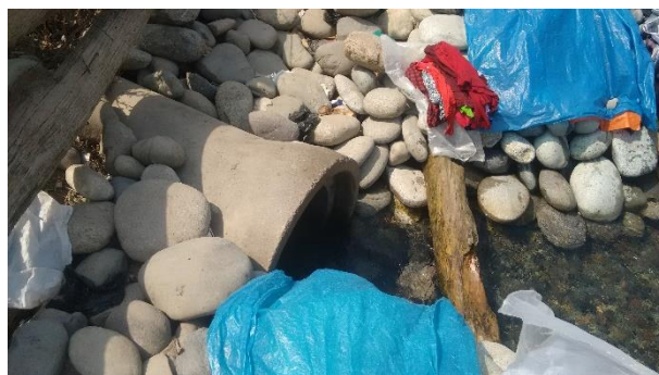
Figura 44. El agua tratada saliente de la PTAR es usada para el lavado de ropa y aseo personal antes de ingresar al río. Fuente: Propia, 2019.
