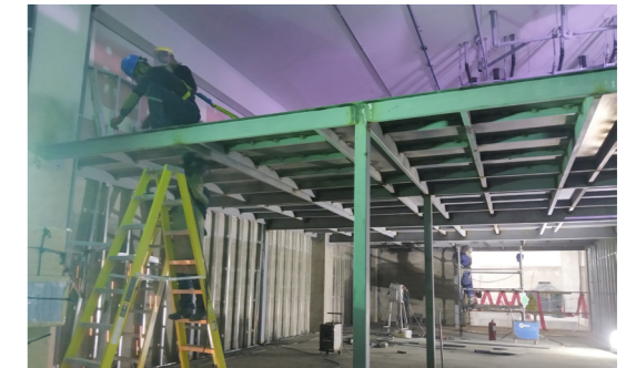
Figura 36: Área de Intervención, Vista de Mezzanine Metálico con plataforma de Planchas Estriadas.
