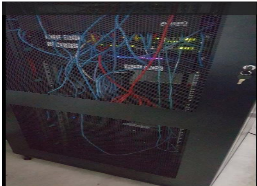
Anexo 11: Servidor principal
