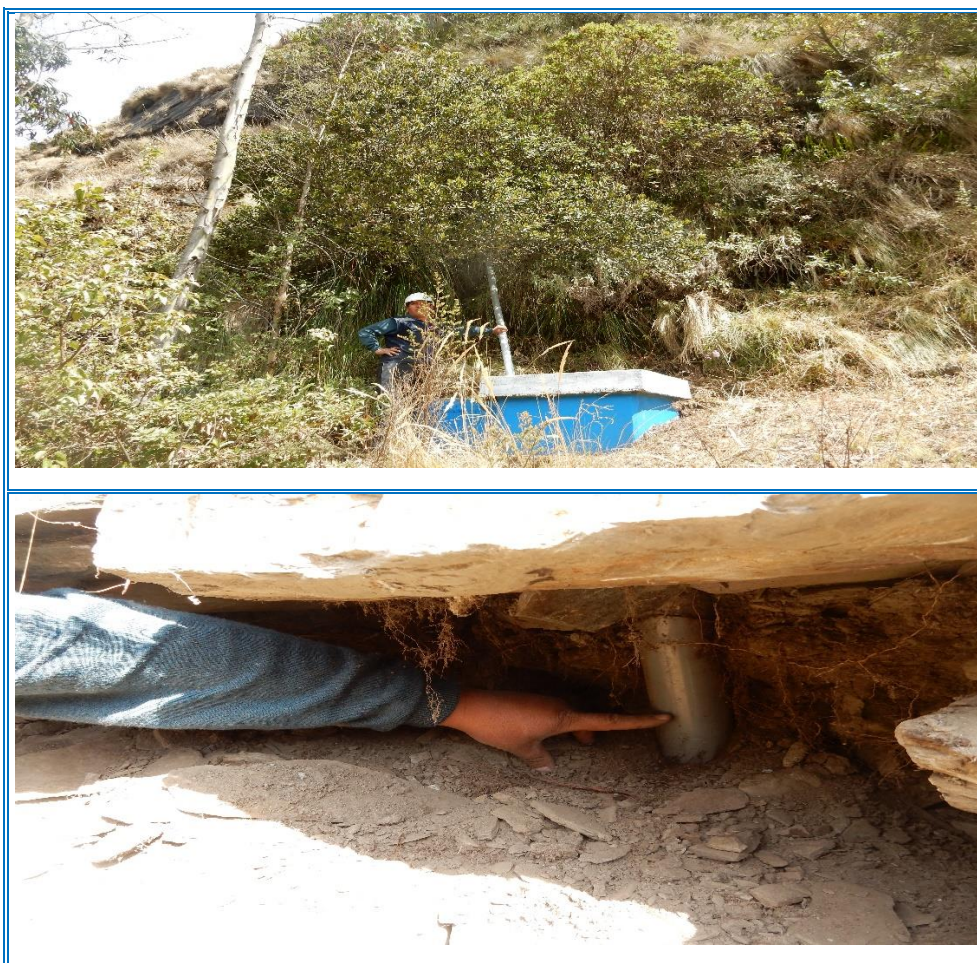
Figura 17. Tubería de la línea de conducción expuesta a la interfiere-visita a campo. Fuente: propia.
