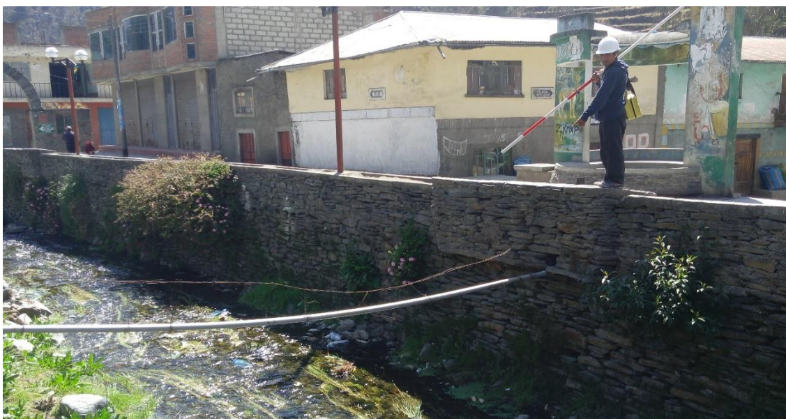
Figura 21. Cruce de río de la red de distribución en situaciones precarias
