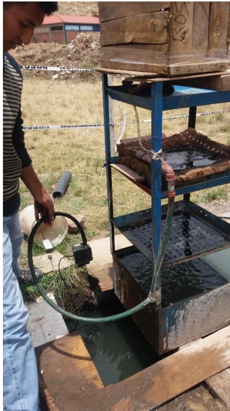
Figura 5. Sistema de bombeo
