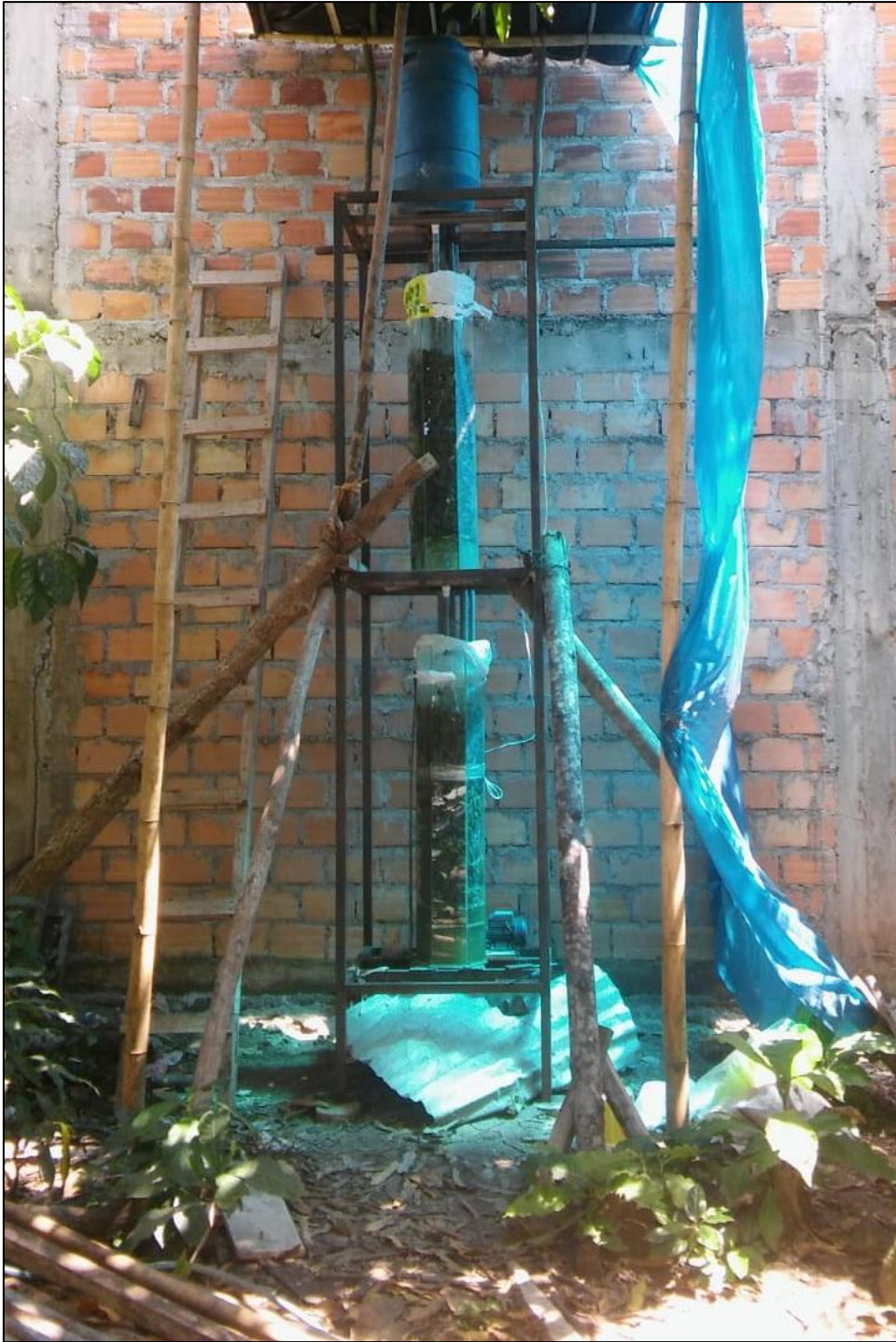
Figura 11. Sistema de Filtros Percoladores en serie terminado
