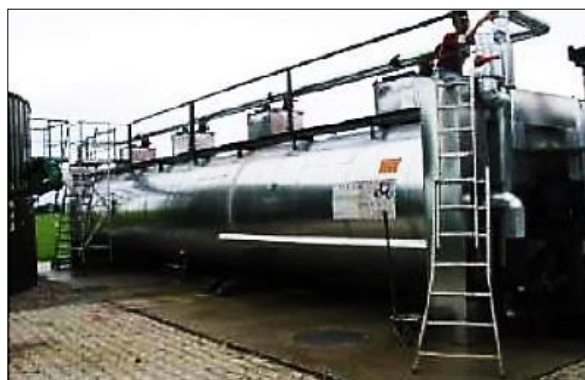
Figura 4. Digestor de carga en batch Fuente: Moncayo Romero, 2013.
