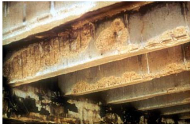
Figura 3. Desconchamiento en vigas de hormigón armado, dejando expuestas las armaduras de acero.
