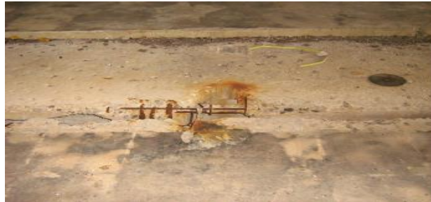
Figura 23. Pérdida de la adherencia.
