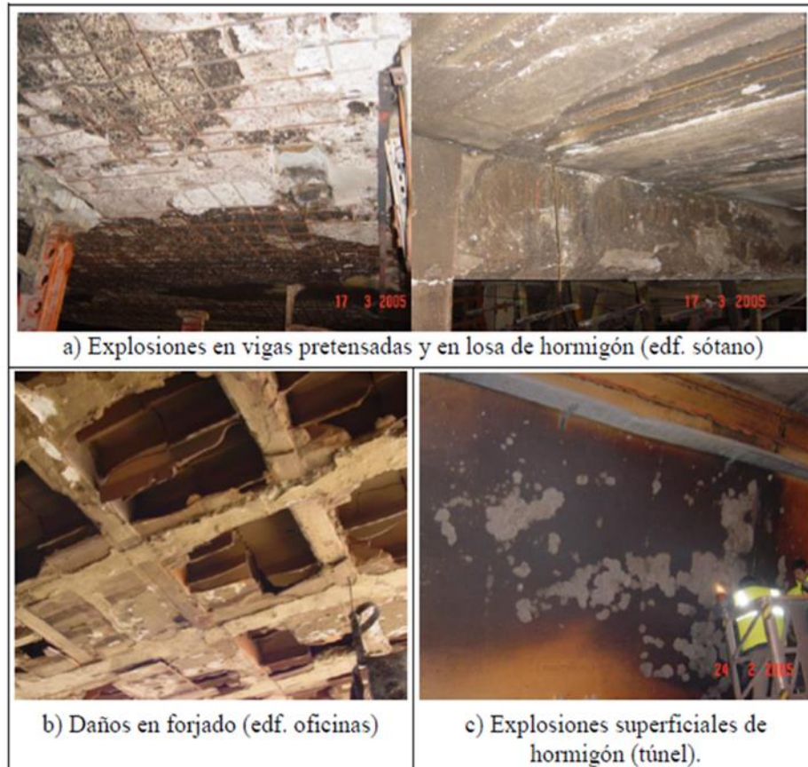
Figura 6. Daños en elementos de hormigón después del incendio.
