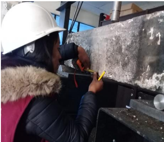
Imagen N°51: Medición de las fisuras
