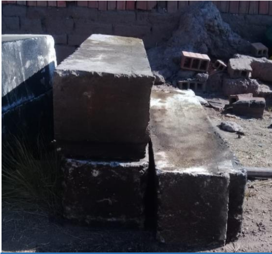
Imagen N°49: Vigas sometidas a fuego
