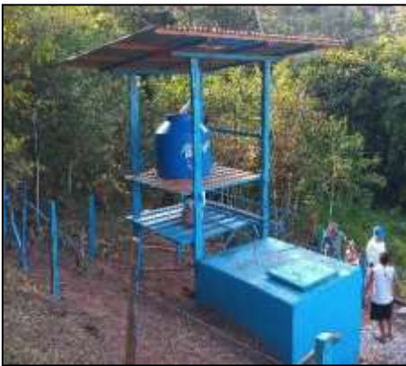
Figura 1. Hipoclorador de goteo de carga constante de doble recipiente instalado.
