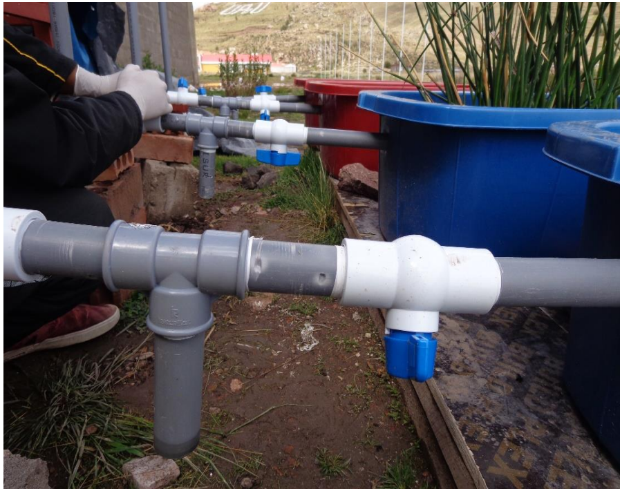
Figura 31. Medición de Caudal
