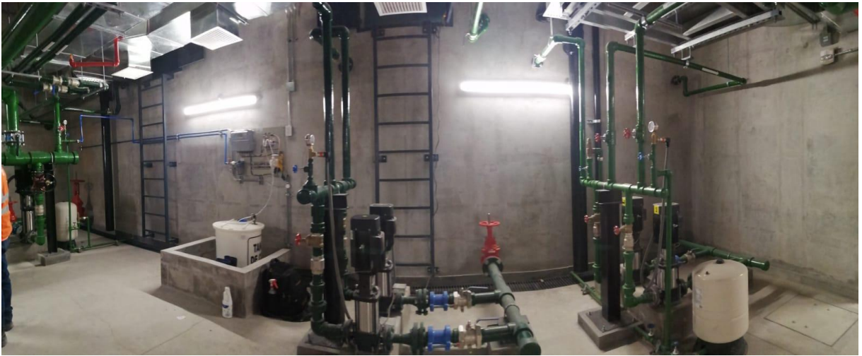
Figura N° 25: Distribución de las tuberías 2
