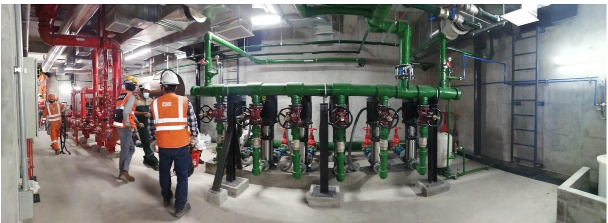
Figura N° 24: Distribución de las tuberías 1
