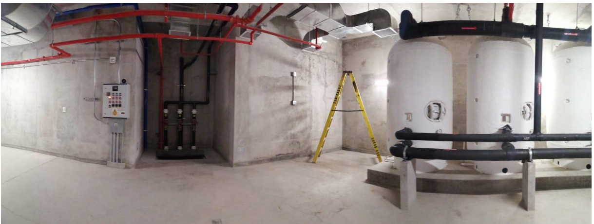
Figura N° 26: Distribución de las tuberías 3
