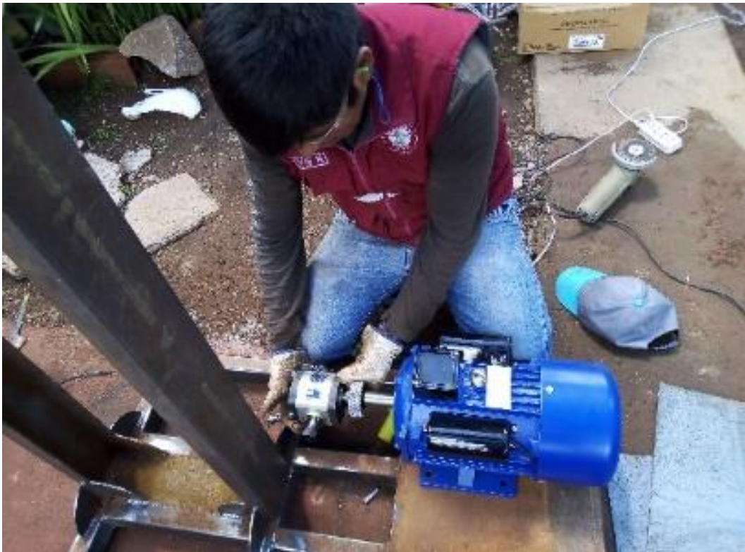
Fotografía 8. Adaptación del motor eléctrico con la bomba hidráulica.
