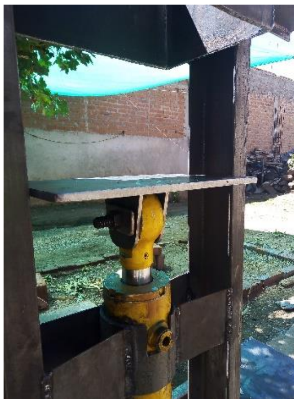
Fotografía 10. Instalación del cilindro hidráulico con la placa base dentro del soporte metálico.
