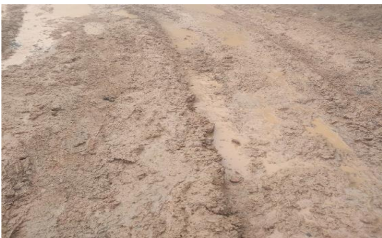
Figura 19. Carretera rural en mal estado consecuencia de las propuestas inadecuadas en la conservación y mantenimiento
