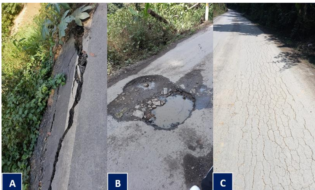
Figura 7. Fallas y deterioros del pavimento flexible
