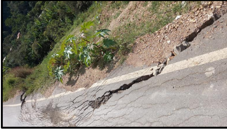
Figura 1. Falla del pavimento flexible en la vía San Juan del Oro a Quispicanchis
