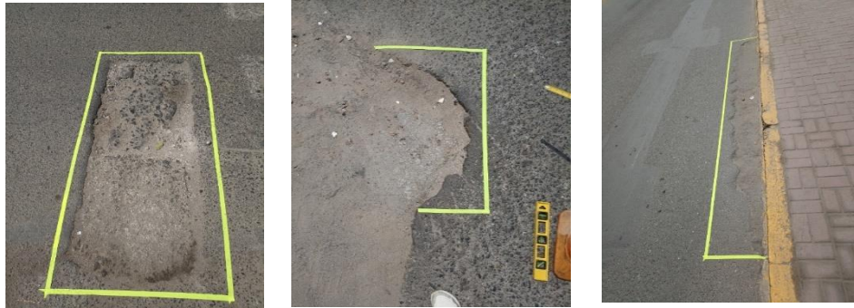
Fig. 3. PRINCIPALES FALLAS ENCONTRADAS EN LA AVENIDA UNIÓN – CHACLACAYO – LIMA
