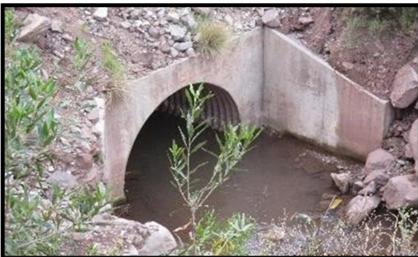
Figura 12. Sedimentación en cabezal de salida, alcantarilla de alivio.
