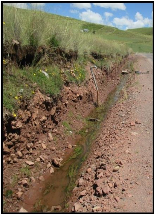
Figura 14. Cunetas de tierra sin pendientes.
