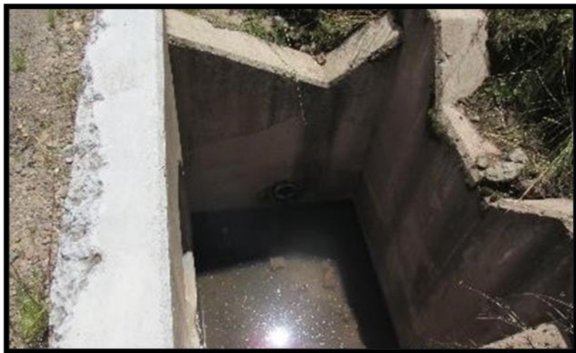
Figura 05. Cabezal de entrada, obstruido.
