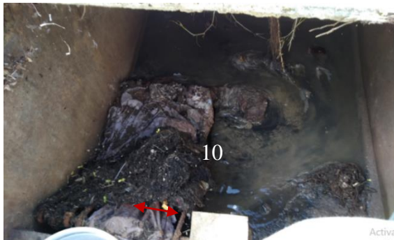
Figura 10. Cámara de rejas
