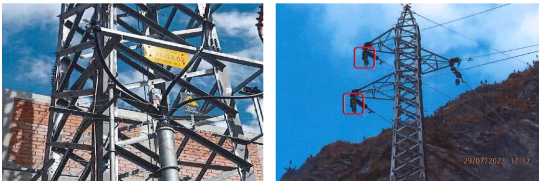
Figura 72: Proyecto 03; vista de identificación y sistema de anti-escalamiento; vista de instalación de pararrayos.
