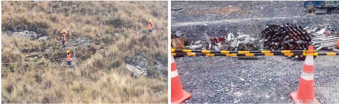
Figura 70: Proyecto 03; apertura de accesos hacia los torres y almacén temporal de aisladores.
