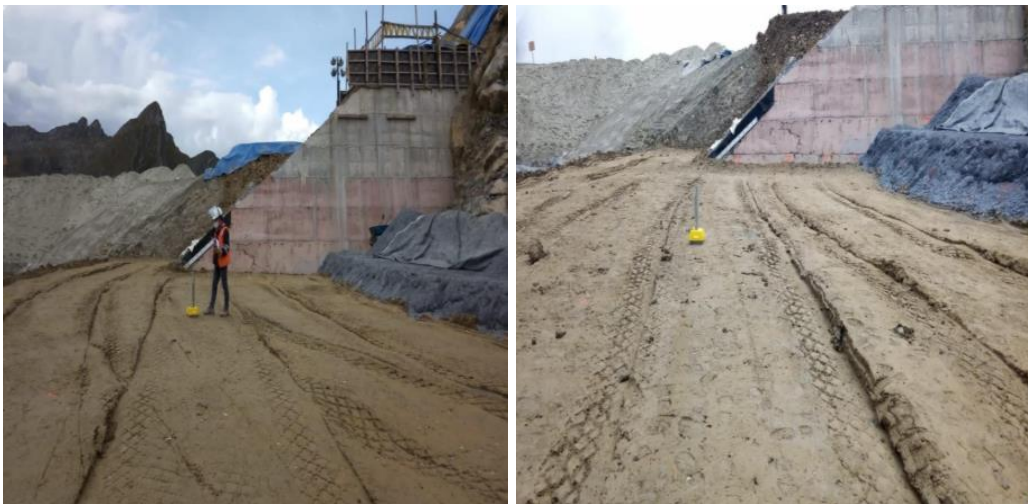
Figura 34: Proyecto 01; control de calidad de compactación de relleno de arena de relaves.
