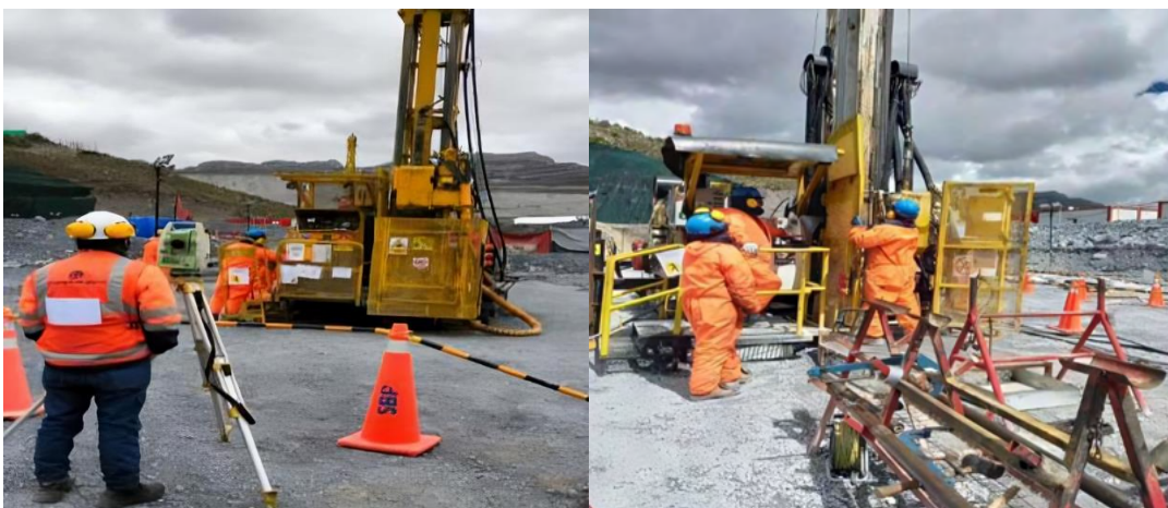
Figura 53: Proyecto 02; trabajo de control topográfico y trabajos de cambio de componentes de equipos de perforación.
