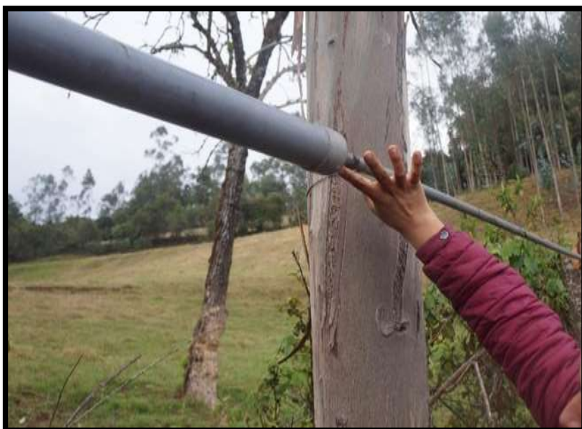
Imagen 33. Conducción del biogás
