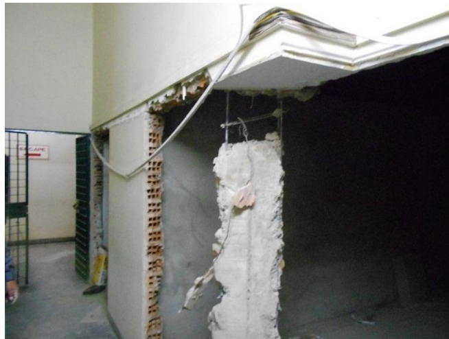
Figura 48 - Daños visibles ocasionados por remodelaciones en el edificio
