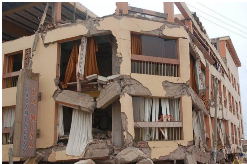
Figura 6 - Colapso del Hotel Embassy de Pisco (Quiroz 2007)
