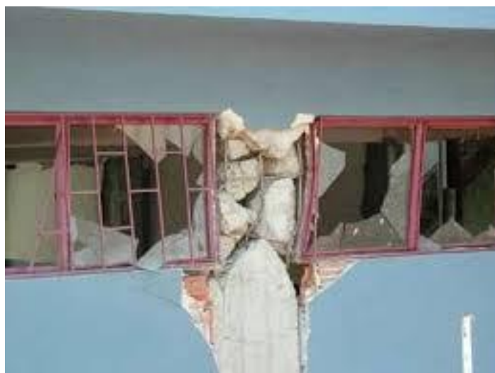
Figura 43 - Falla de una columna por rotula plástica
