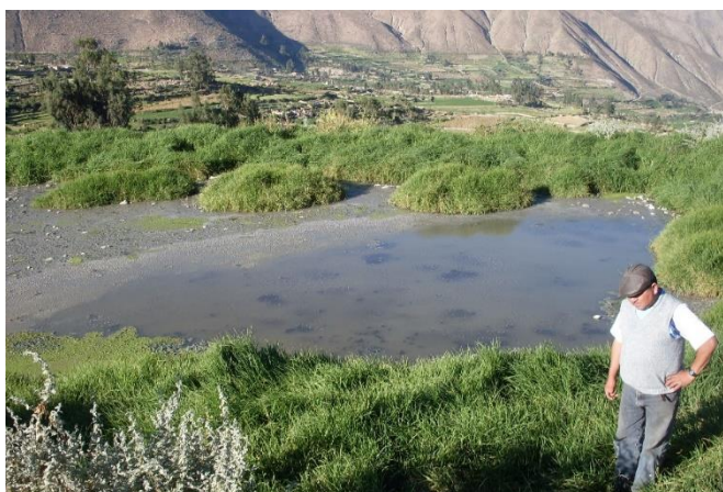
Figura 35 - Vista de la laguna facultativa primaria colapsada
