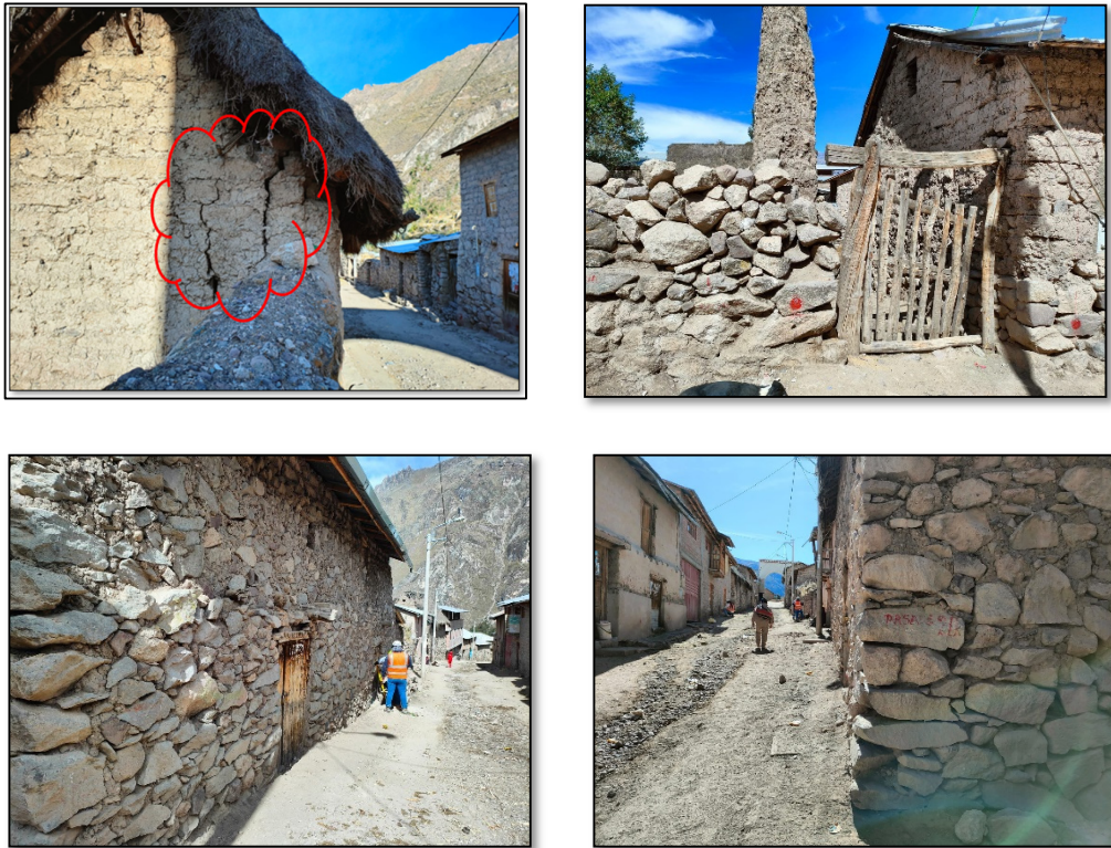
Figura N° 23 Estado de viviendas de adobe antes de la ejecución de obra. Fuente: Elaboración propia.
