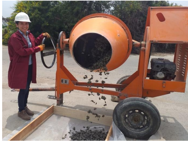
Figura 46. Vaciado de la mezcla de concreto permeable en el tramo de prueba.
