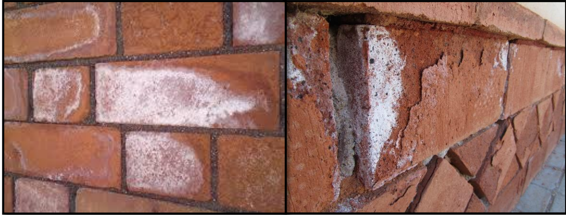
Figura 2.7. Eflorescencias en el ladrillo. Fuente: Aguirre & Baeza, 2015, p.1.
