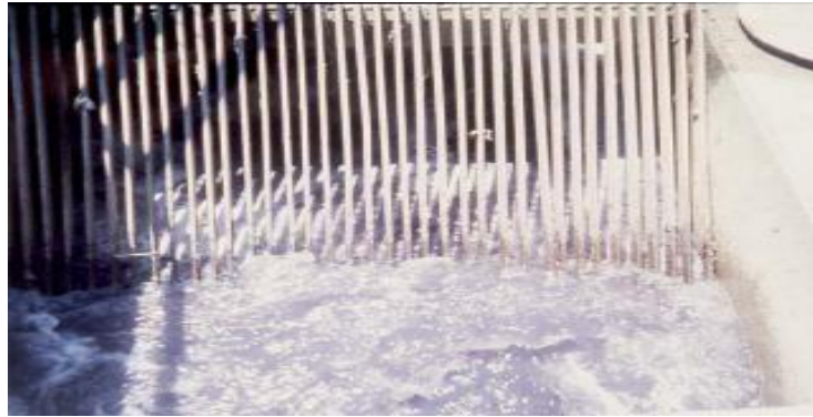
Figura 5. Cribas o cámara de rejas (Caicedo, 2017)
