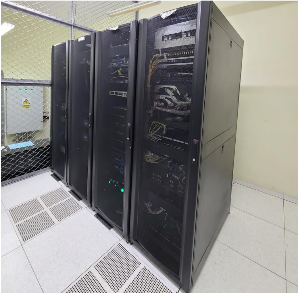
Figura 14. Racks de equipos de telecomunicaciones
