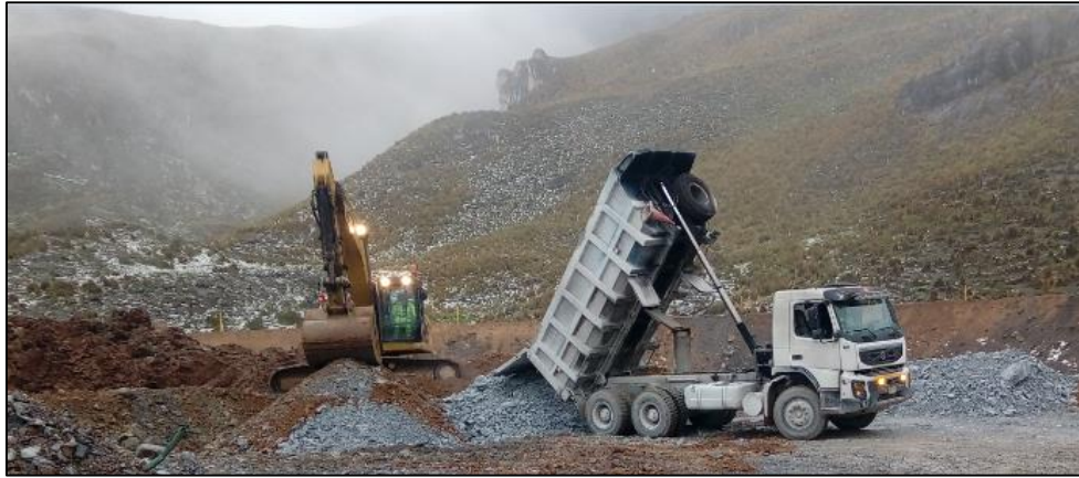
LA EXCAVADORA CAT 330, SE DEDICO AL BLENDEO Y CARGUIO DE MATERIAL EN DME.
