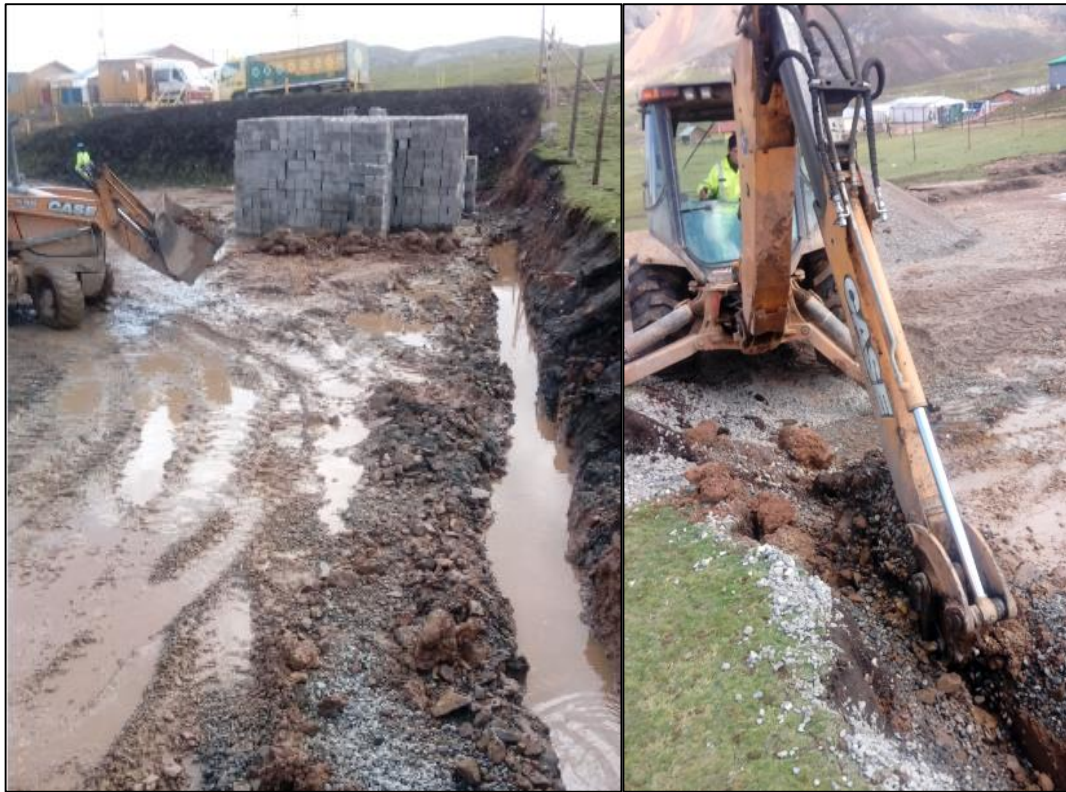
Suelo saturado en Plataforma Yumpag
