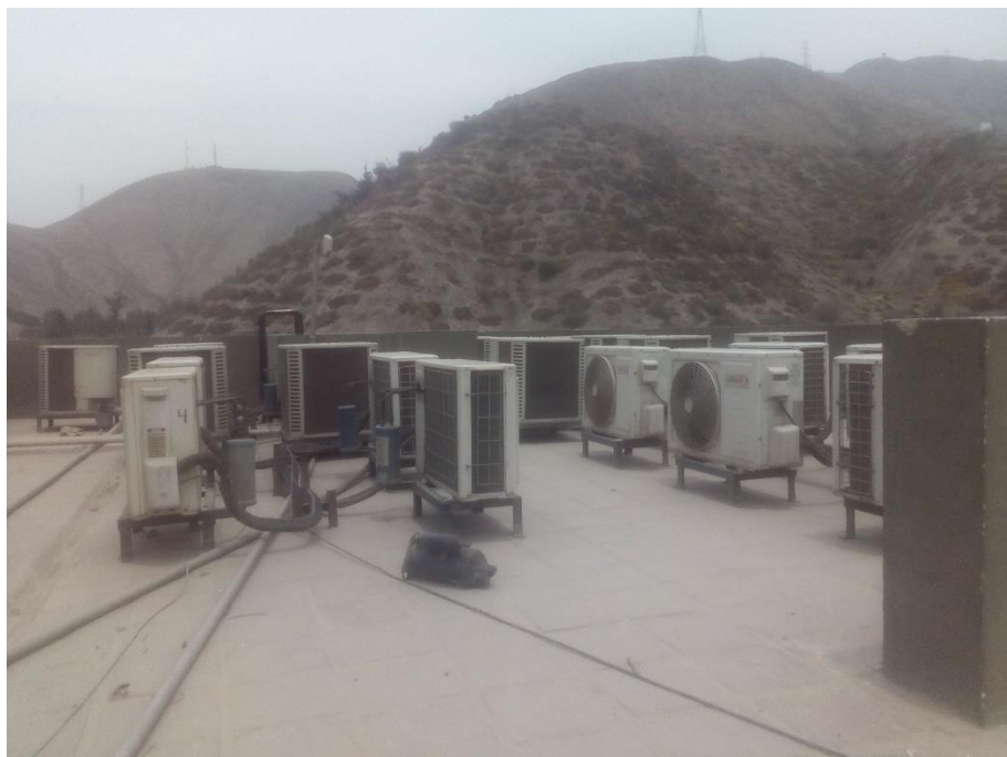
Figura 3. 33 – Equipo de ventilación del edificio.
