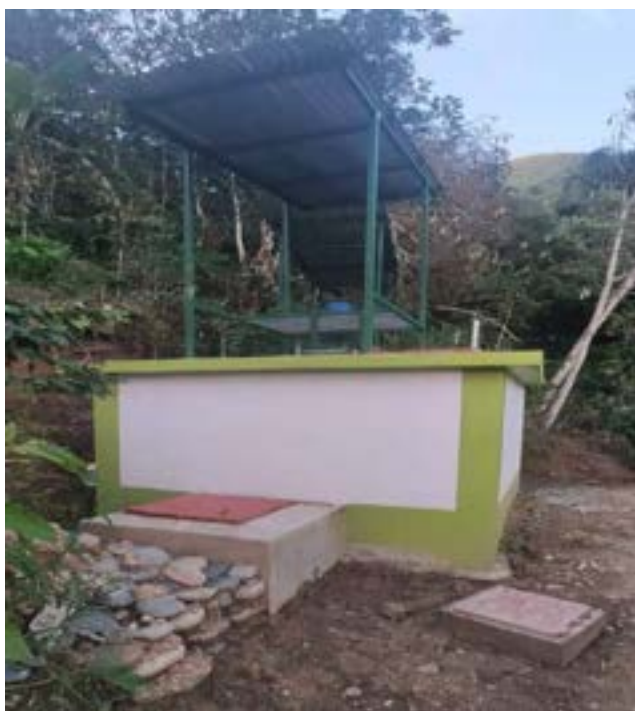
FOTO N° 05. Reservorio de concreto de 5m3 en el SUB-SIST-02
