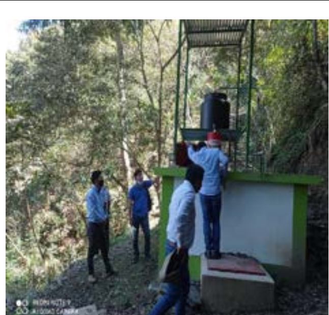
FOTO N° 04. Reservorio de concreto de 5m3 en el SUB-SIST-03
