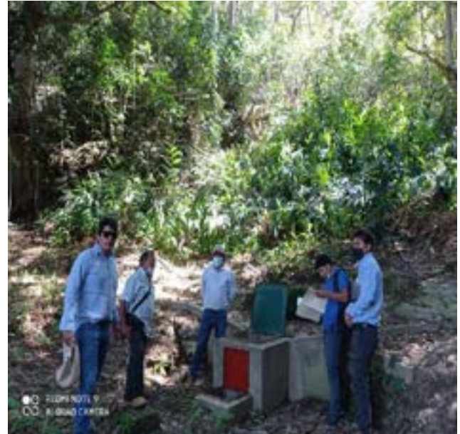
FOTO N° 02. Captación de ladera SUB-SIST-01
