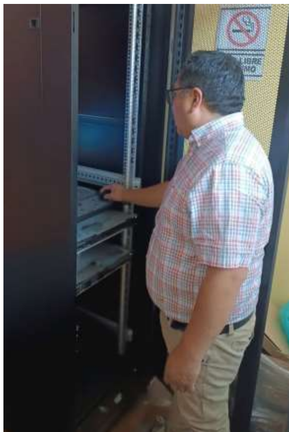
Imagen N°7 – Oficina del Área de informática, servidor de la empresa donde están instalados los sistemas de la empresa.
