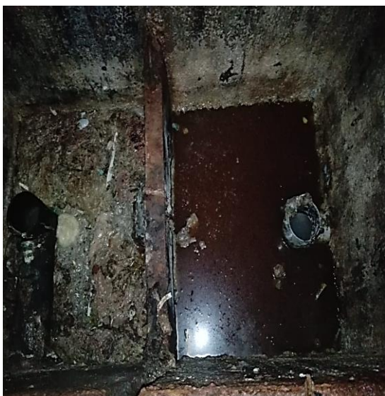
Figura 30. Trampa de grasa de aguas residuales del servicio de alimentación hospitalaria - Instituto Nacional de la Salud del Niño, San Borja
