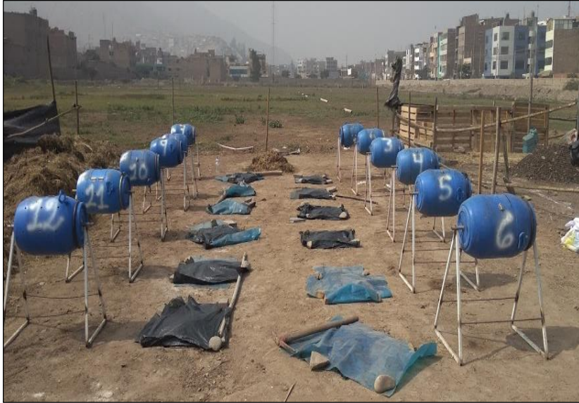
Figura 80. Pilas dinámicas debidamente cubiertas
