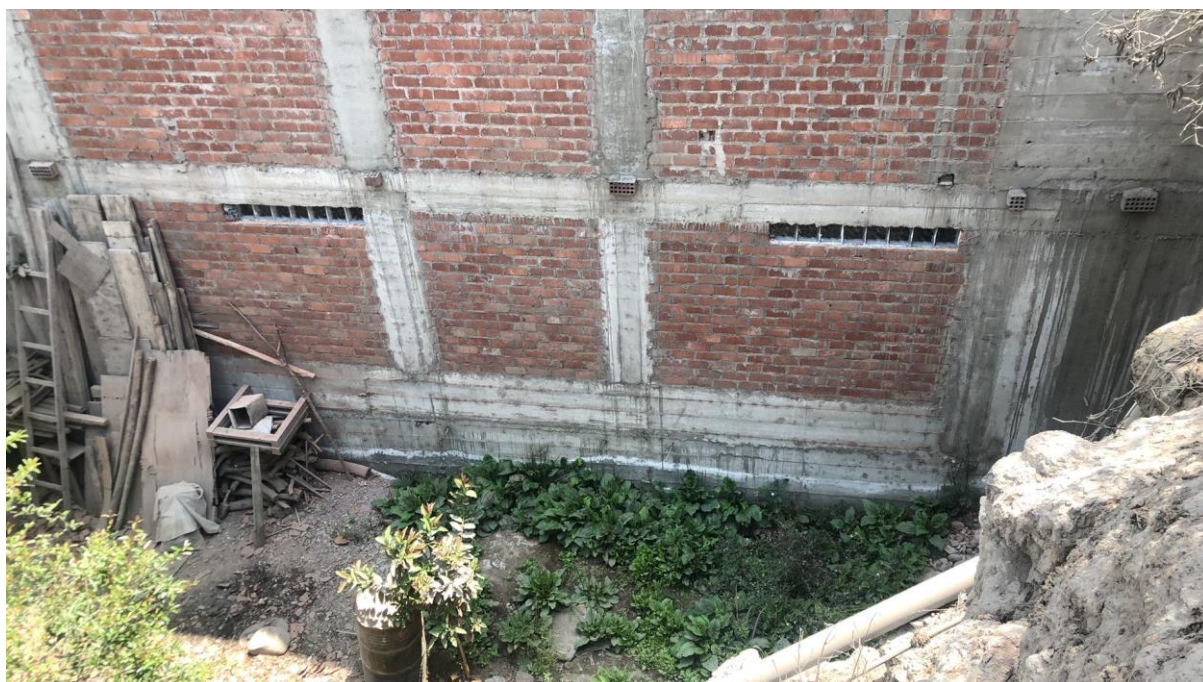
Imagen 42: Asentamientos diferenciales y pérdida de resistencia de materiales. Fuente: Elaboración Propia.
