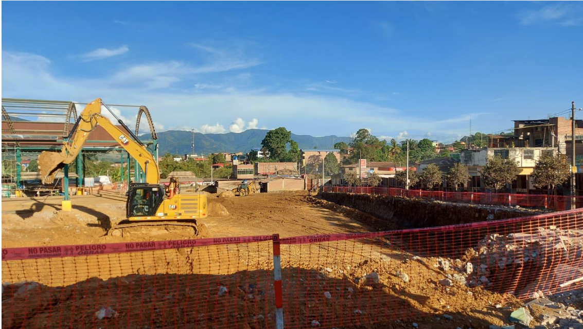
Figura 36: Malla y cinta de seguridad en el perímetro de la excavación del bloque 01, 02, 03 y 04 – Primaria.
