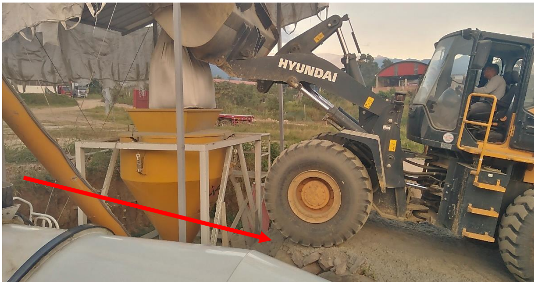
Figura 100: Peligro de caída de maquinaria.
