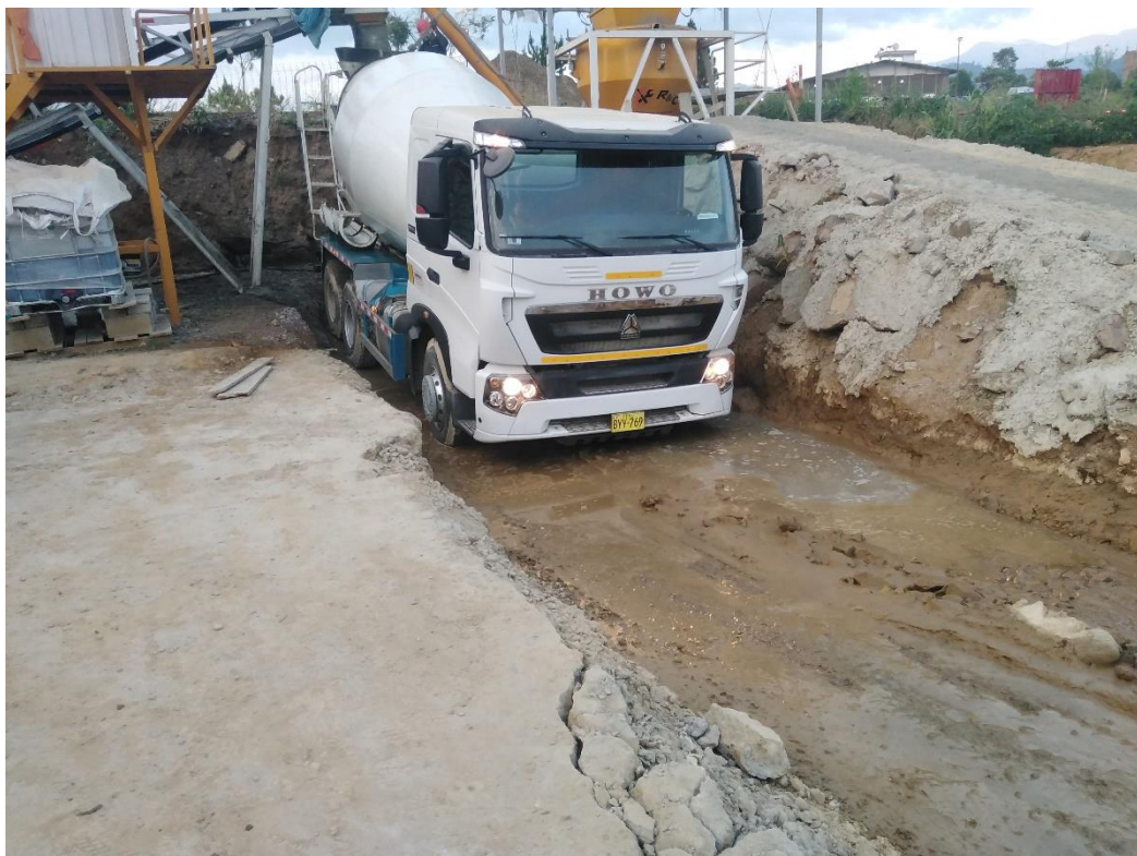
Figura 101: Zona de carga inundada.
