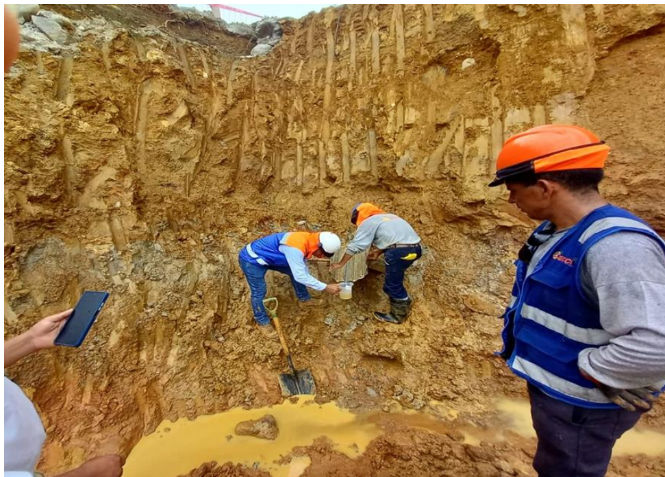
Figura 103: Se aprecia la medición del caudal de agua que nace del talud de corte entre la plataforma 01 y 02 - Primaria.
