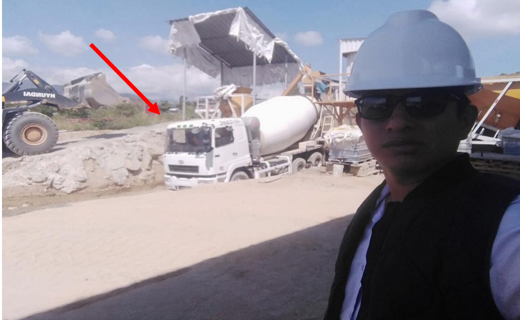
Figura 99: Zona de generación de desperdicio de cemento.
