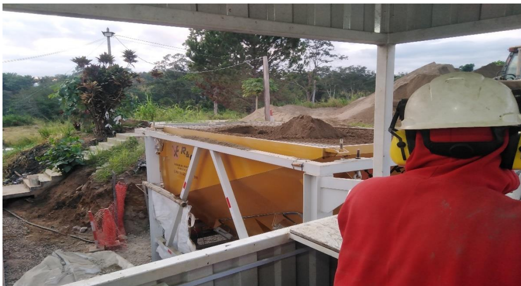
Figura 98: Torre de control de la planta de concreto.
