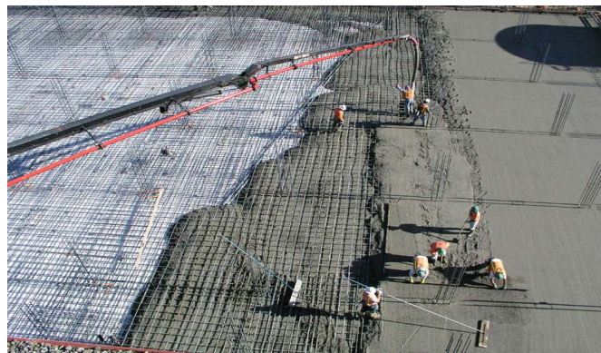
Figura 1. Formación de una junta fría en losa de concreto.
