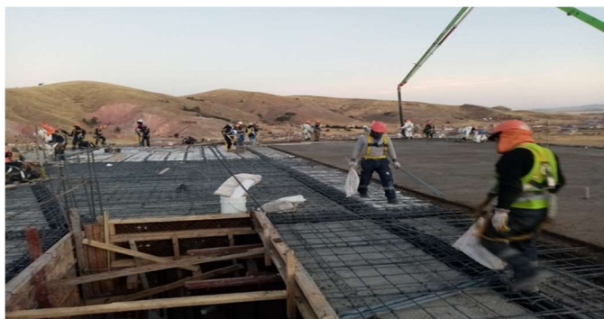
Figura 2. Generación de junta fría por vaciado de concreto en losas y vigas.
