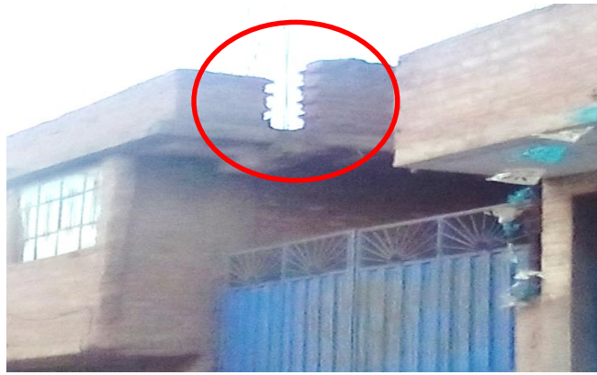
Figura 7.41. Losa invadiendo la propiedad vecina, Salida Cusco.
