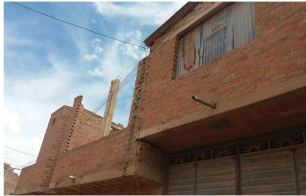
Figura 7.42. Losa del segundo piso invadiendo la propiedad vecina, Salida Cusco.
