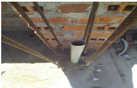
Figura 7.35. Acero de continuación expuesto a la intemperie con presencia de corrosión en la columna, Av. 3 de octubre s/n, Salida Cusco.
