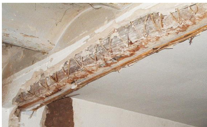
Figura 7.34. Acero de refuerzo expuesto a la intemperie con presencia de corrosión, Jr. 12 de agosto 324, Salida Cusco.
