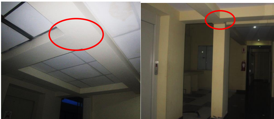
Figura 7.9. Falta de la columna en el encuentro de las vigas, Jr. Santa Juana con Primavera, Salida Huancane.
