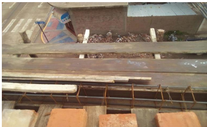
Figura 7.32. Empleo de acero oxidado en la construcción de una vivienda, Calle nueva N° 2 con Pierola, Salida Huancané.
