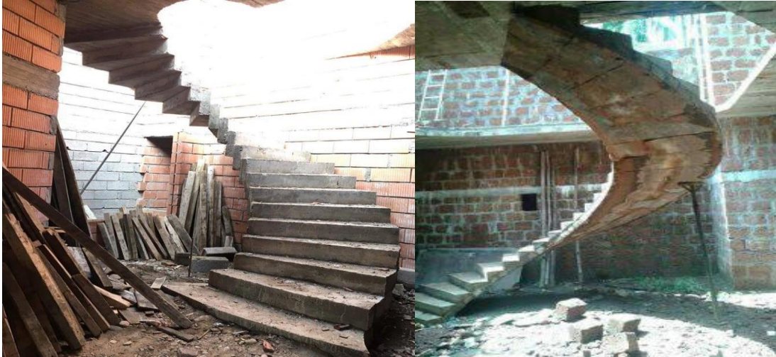
Figura 7.30. Falta de columnas de apoyo para la escalera, Jr. Villa salvador 324, Salida Cusco.
