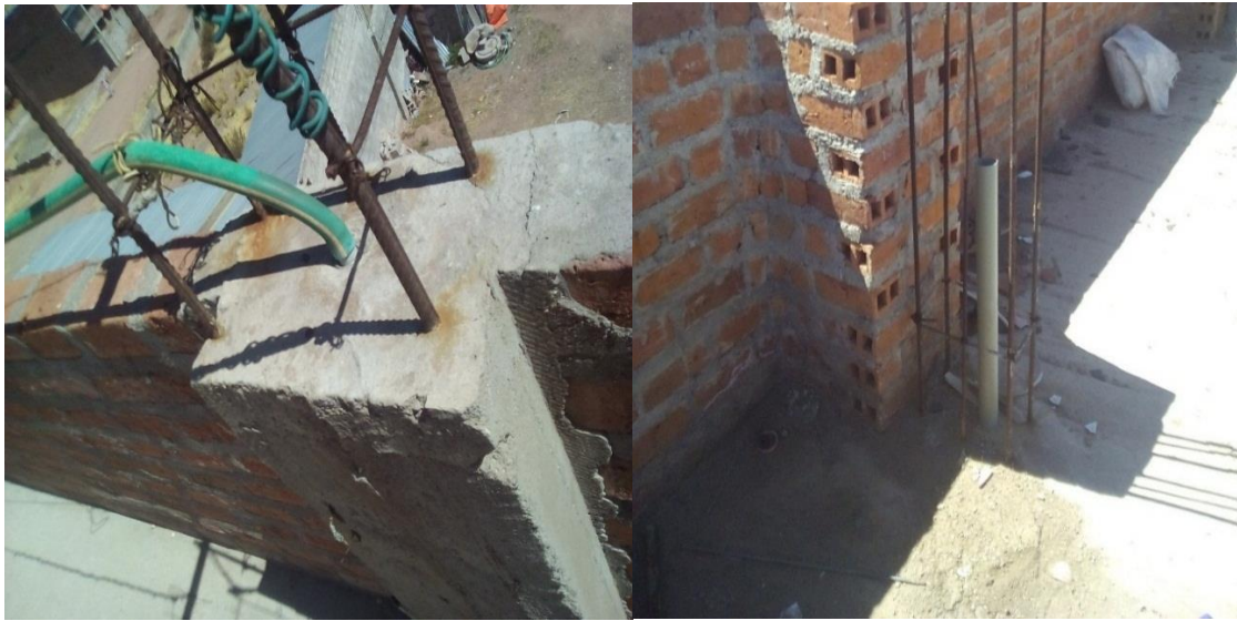
Figura 7.8. Instalaciones sanitarias dentro de las columnas, Av. 3 de octubre s/n, Salida Cusco.
