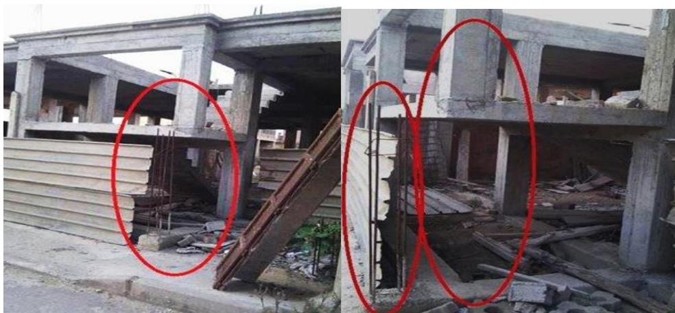
Figura 7.3. Columna mal distribuida en la vivienda, Salida Cusco.
