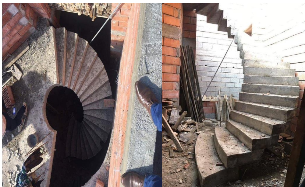
Figura 7.29. Escalera apoyada a la losa del segundo piso, Jr. Villa salvador 324, Salida Cusco.
