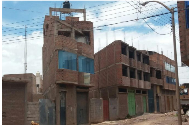
Figura 7.13. Vivienda con irregularidad en planta y altura debido al área del terreno, Salida Huancane.
