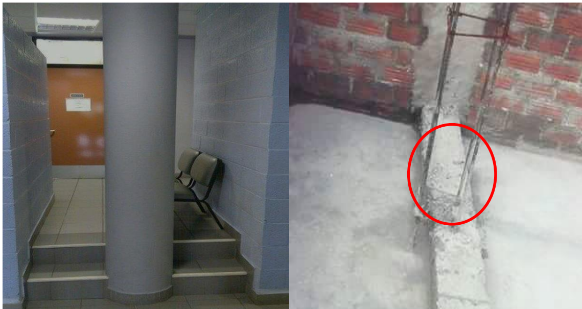
Figura 7.5. Mala distribución de la columna en la vivienda, Jr. 6 de agosto con san francisco.
