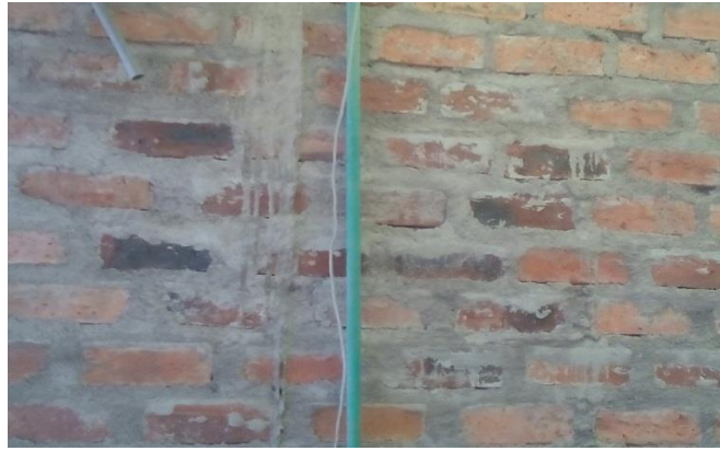
Figura 7.39. Ladrillos a distintos grados de cocción dentro del muro de una vivienda, Psj. H de la torre 231, Salida Cusco.
