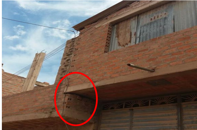
Figura 7.15. Viviendas con losas a diferente nivel y falta de junta sísmica entre viviendas, Salida Cusco.
