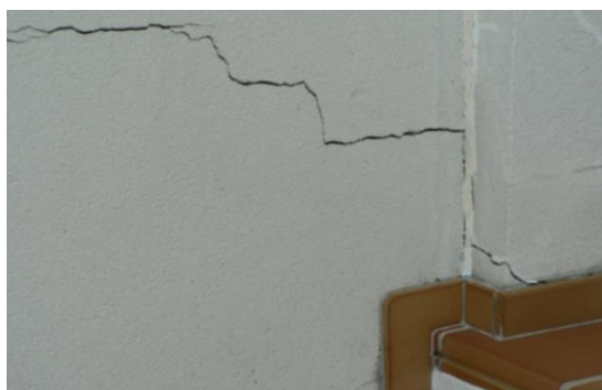
Figura 7.1. Fisura por asentamiento en vivienda, vivienda 21, Jr pierola 1439.
