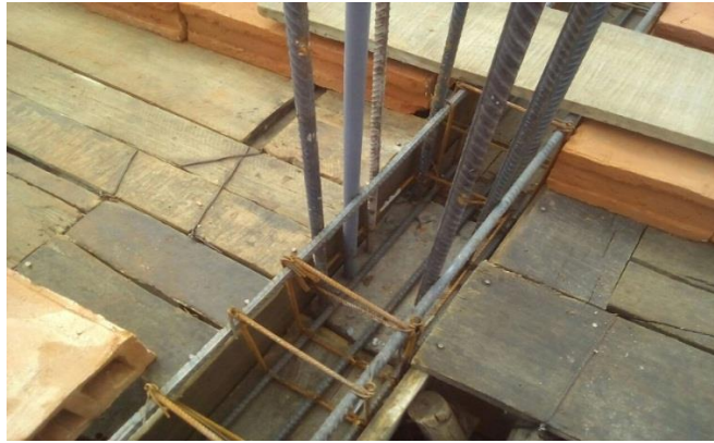
Figura 7.31. Empleo de acero oxidado en la viga, Calle nueva N° 2 con Pierola, Salida Huancané.
