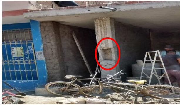
Figura 7.21. Columna de viviendas picadas, Jr. Yungay con Av. infancia, Salida Huancané.
