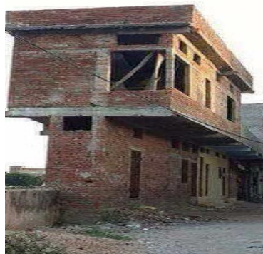
Figura 2.9. Irregularidad vertical en una vivienda, Salida Cusco.
