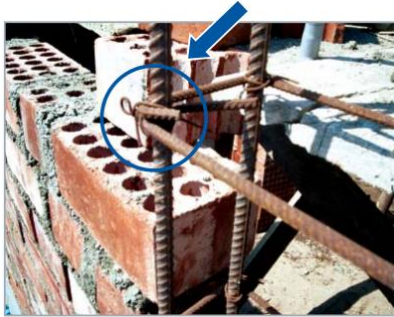
Figura 35. Buen uso de ladrillo pero acero oxidado y escasa longitud de gancho (UNACEM, 2014).
