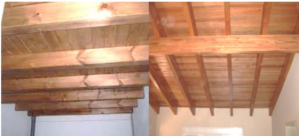
Figura 7.11. Viviendas con piso de madera en el segundo nivel en reemplazo de la losa de concreto, Salida Cusco.
