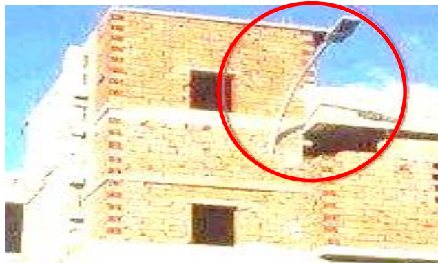
Figura 7.40. Poste de energía eléctrica sobresaliendo de una vivienda, Salida Cusco.
