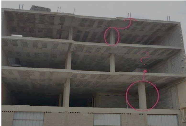
Figura 7.6. Mala distribución de las columnas en la vivienda, Salida Cusco.
