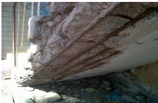
Figura 7.33. Acero de refuerzo expuesto a la intemperie con presencia de corrosión, Jr Floral s/n, Salida Cusco.
