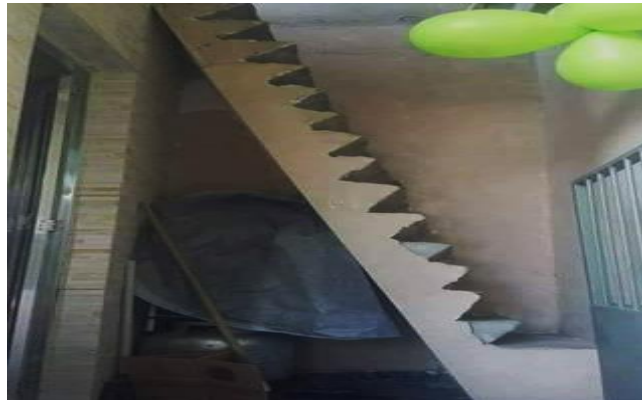
Figura 7.26. Escalera deficiente en una vivienda, Jr. Miraflores 213, Salida Huancané.
