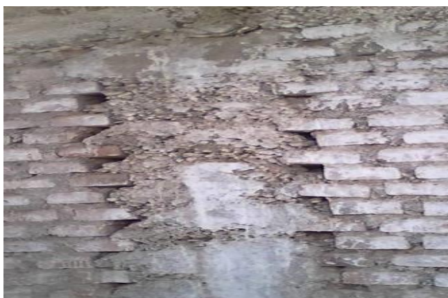
Figura 7.28. Presencia de cangrejeras en la columna, Jr. Moquegua 1434, Salida Huancane.
