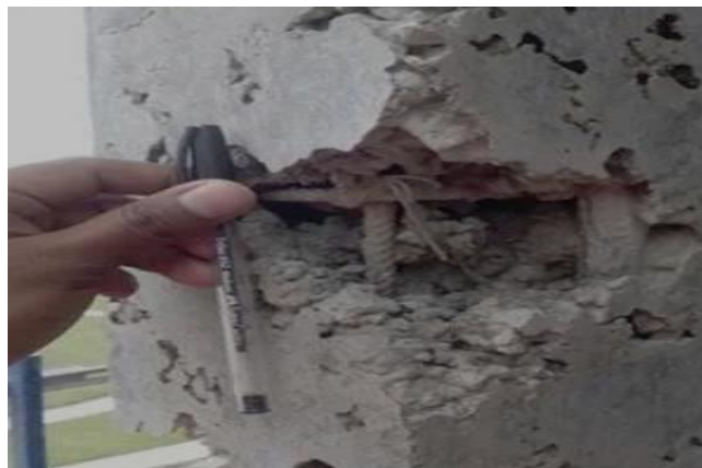
Figura 7.27. Columna con presencia de cangrejeras, Jr. Miraflores 213, Salida Huancané.
