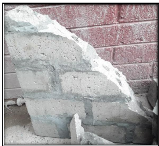
58) Buena adherencia mortero - unidad
