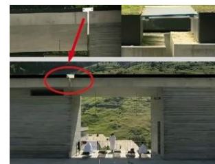
Detalle de la entrada de la luz, buscando evocar la penumbra de la cueva, como referente del proyecto.
