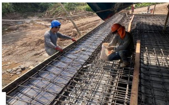
Figura 26: Armado de acero para vigas y losa de la plataforma del puente.
