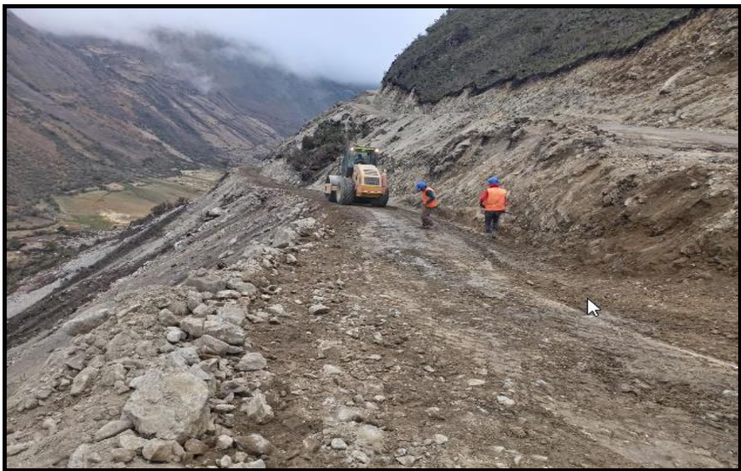
Figura N° 61 Vista del rodillo liso realizando la compactación de la prog. 1+020 hasta prog. 0+480
