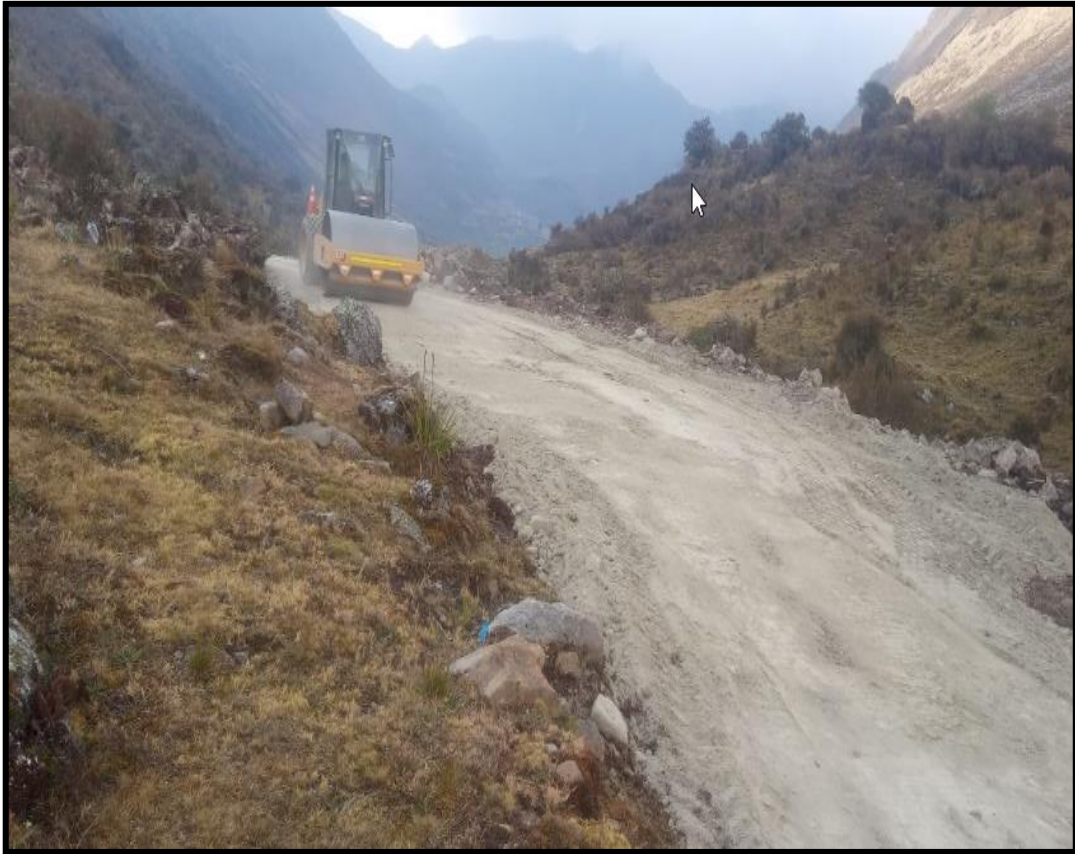
Figura N° 62 Vista del rodillo liso realizando la compactación de la prog. 0+000 hasta prog. 0+480
