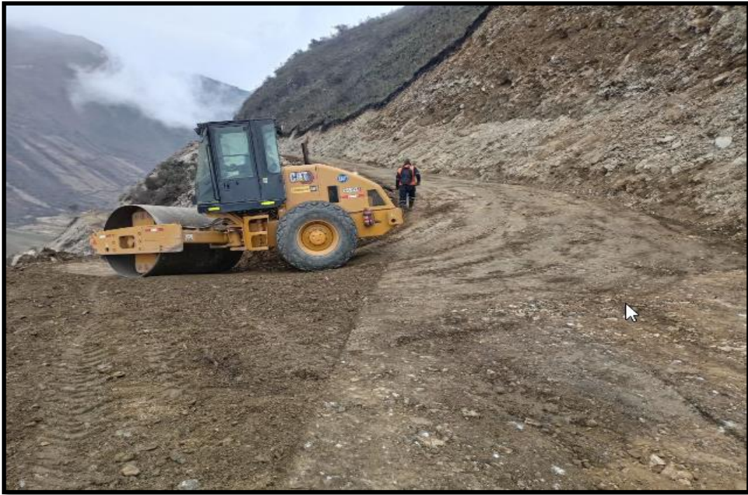
Figura N° 60 Vista del rodillo liso realizando la compactación de la prog. 1+020 hasta prog. 0+480.
