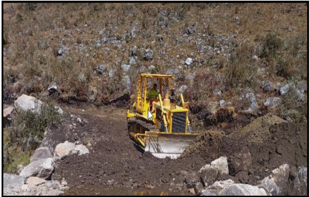
Figura N° 50 Vista de conformación de terraplenes con material propio prog. 0+000 hasta la prog 0+480.
