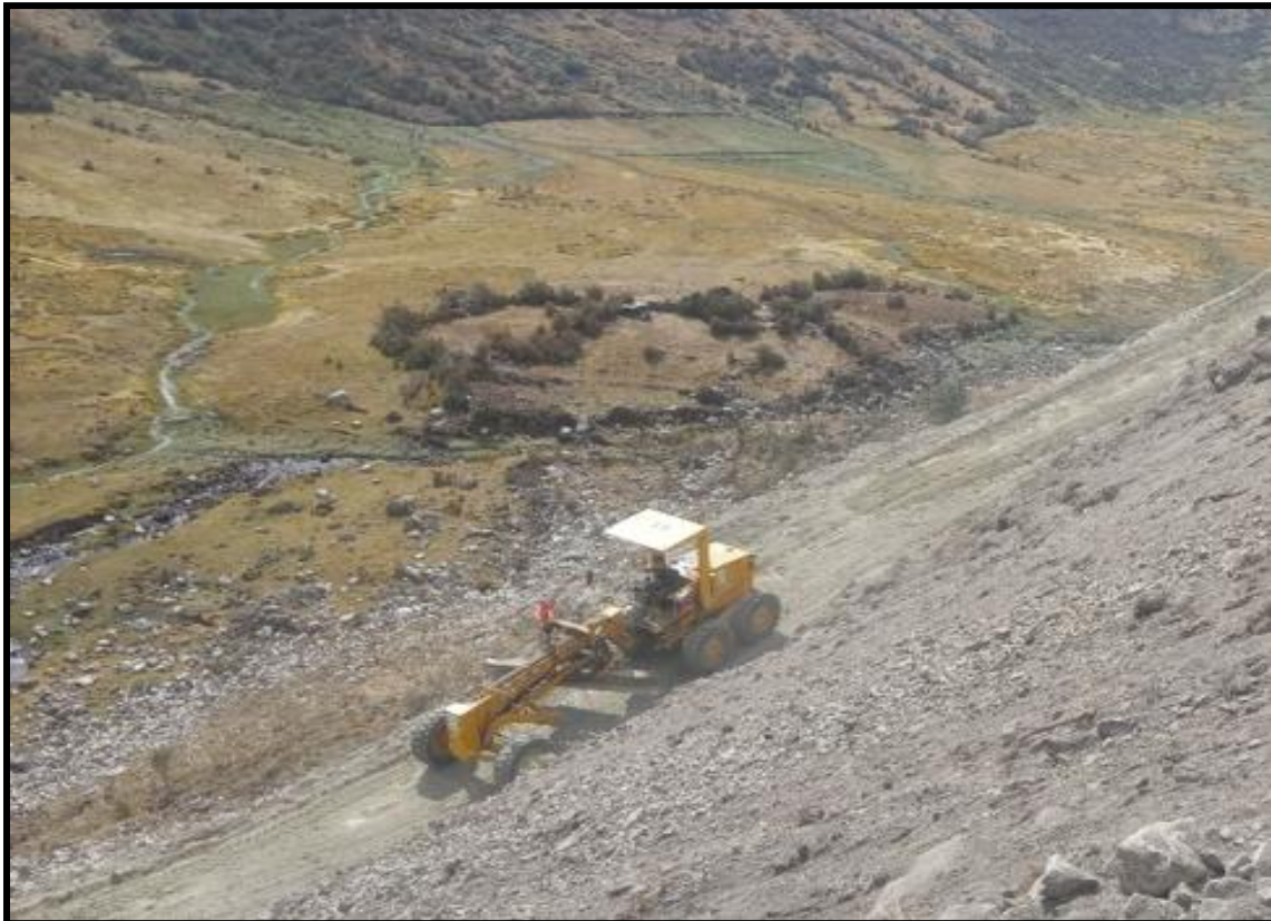
Figura N° 54 Vista de conformación de terraplenes con material propio prog. 0+000 hasta la prog 0+480.
