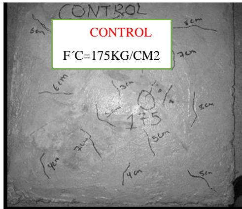
Figura 27. Fisuración en losas de concreto con adición de fibras de Chilihua: 2.5 cm y 5 cm
