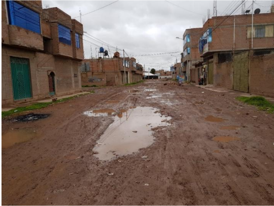
Figura 3: Presencia de Charcos, Agua en Temporada de Lluvia Fuente: Elaboración propia
