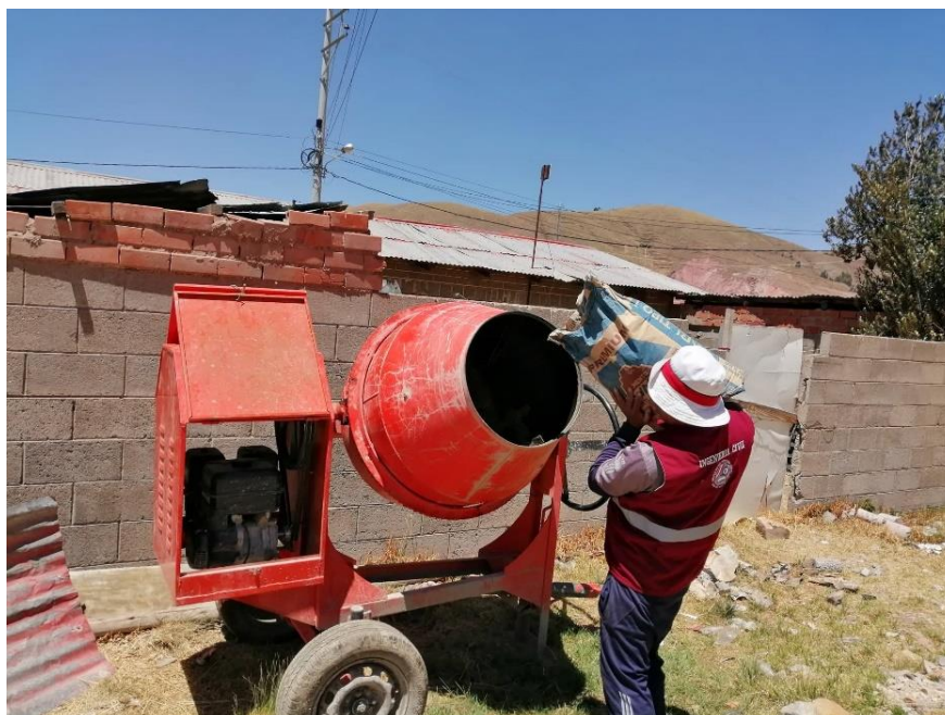
Fotografía 21. Mezcladora de concreto 11 Pie3 utilizada para la elaboración de especímenes.
