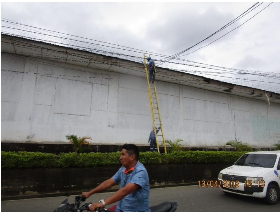
Fotografía N° 8 Supervisión de trabajos de instalación de nuevo suministro a personal contratista del área comercial
