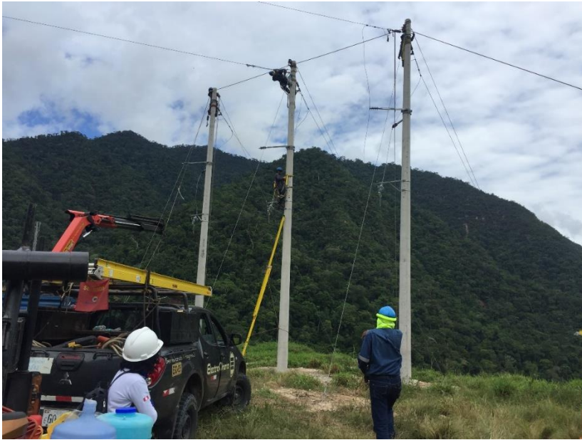
Fotografía N° 7 Supervisión de trabajos de mantenimiento y tendido de cable en líneas de media tensión al personal propio
