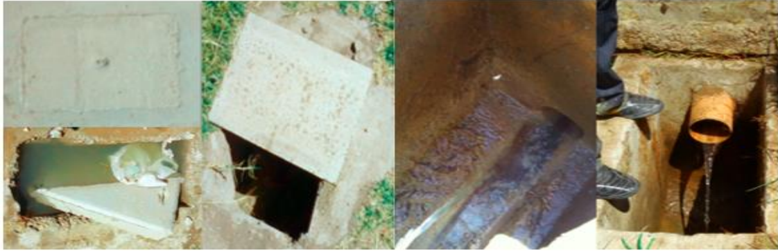
Figura 22. Estado actual de la red de Alcantarillado.
