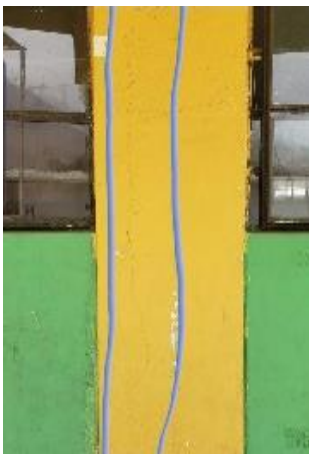
Figura. 33. Rajaduras longitudinales en columnas. Fuente: Fotografía propia.
