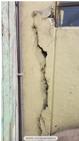
Figura. 31. Rajaduras en columnas. Fuente: Fotografía propia.
